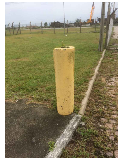
04 POSTE DE CONCRETO Volume: 0,30m 3
