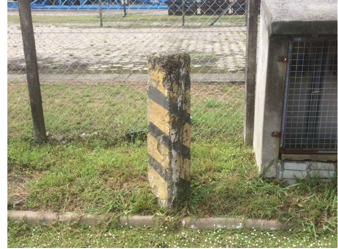
06 POSTE DE CONCRETO Volume: 0,13m 3
