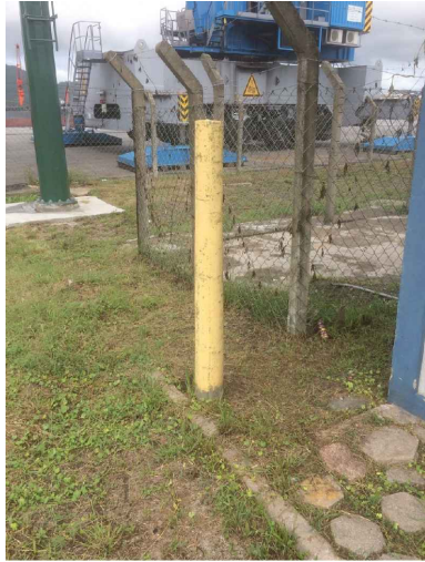
05 POSTE DE CONCRETO Volume: 0,06m 3
